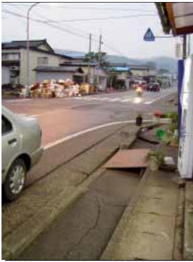
歩道が陥没して段差が(栖吉地域で)
