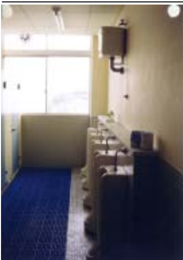
取替前のハイタンク式トイレ
